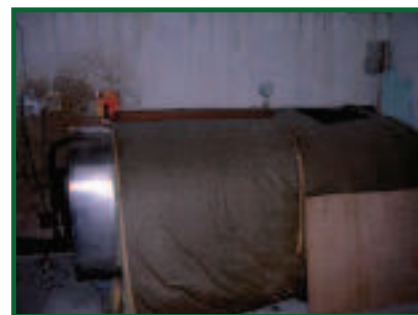
Tank à lait recyclé en ballon tampon
