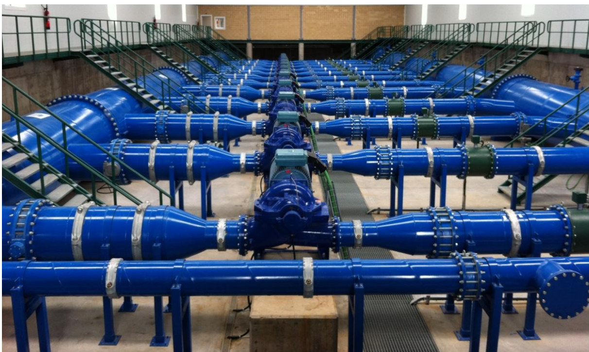
Estación de Bombeo. © Comunidad General de Regantes del Canal del Páramo
