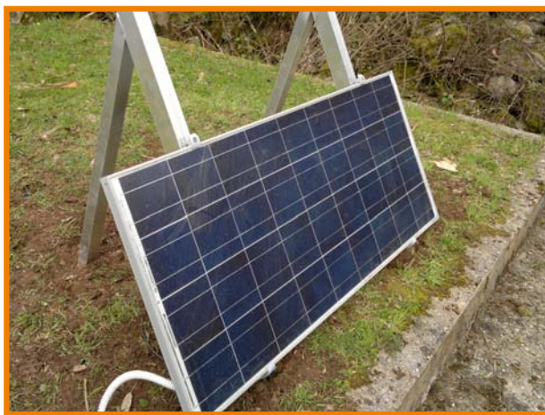
Fig.15. Placa solar instalada
