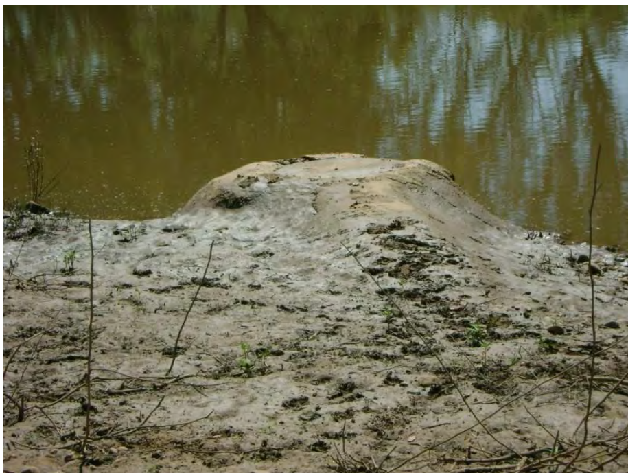
Figura 77. Alcantarilla cubierta de lodo en orilla derecha. Fuente: Depaex
