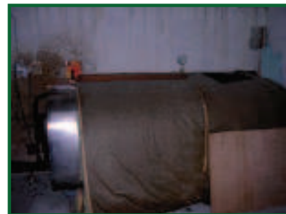
Tank à lait recyclé en ballon tampon
